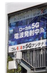
ローカル5G設備
